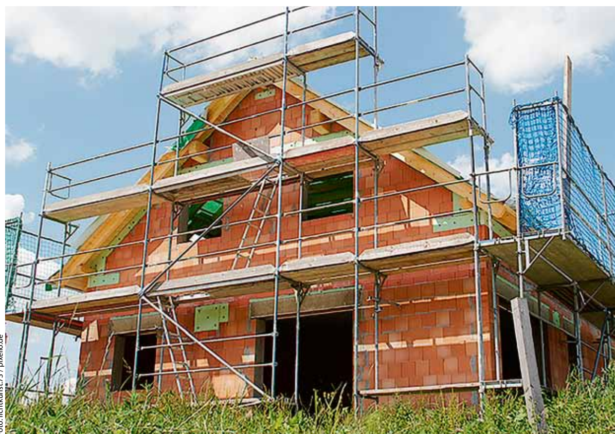
Baumängel sorgen immer wieder für Streit am Bau.
